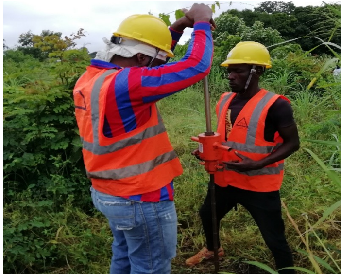
Sondage pénétrométrique sur le site de construction de la station-service d'Atakpamé (Togo)
